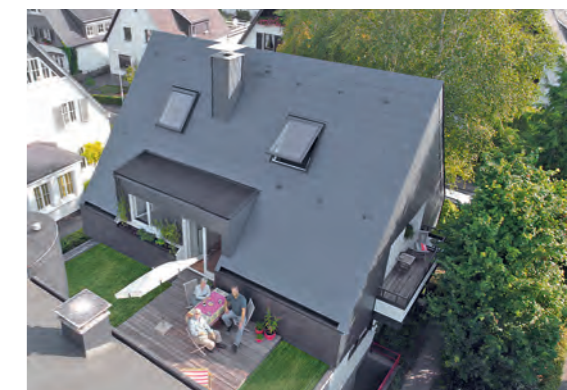
Ökologisch und ökonomisch, zeitlos modern und langlebig: Familie Arens sanierte die asbesthaltige Hülle des Zwei-Generationen-Hauses mit dem neuen Schiefer-System.
